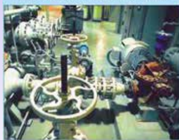
Zonas de fugas o derrames de fluidos
